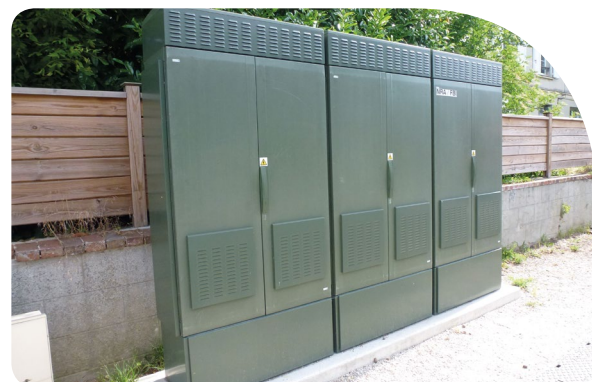
Sous-répartiteur de Fontenay-lès-Briis
