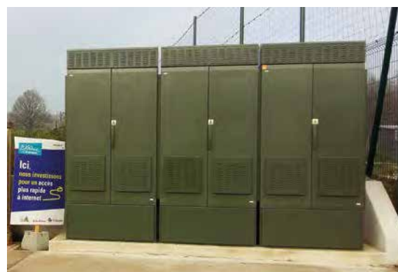
Armoires de montée en débit à Forges-les-Bains
